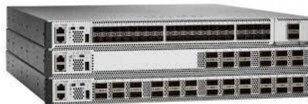
Figura 31 Switch de Agregación Cisco Catalyst 9500
