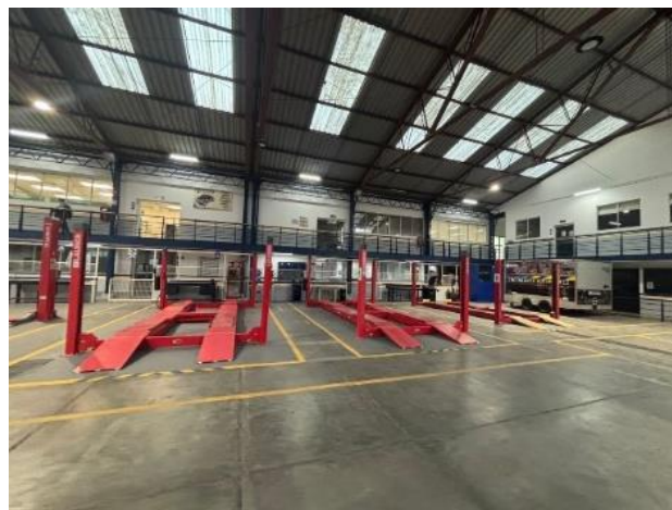
Figura 16. Elevadores de vehículos del Patio-Taller Zona 2
