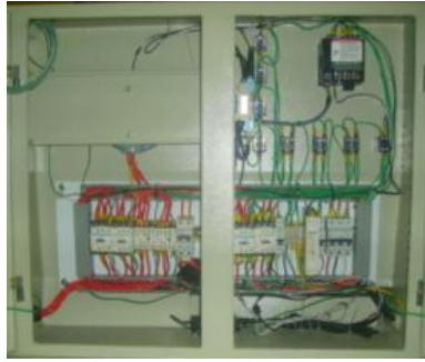
Figura 59 Cableado interno del contrastador de medidores.
