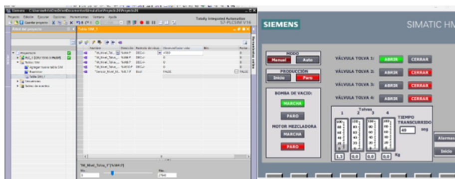
Figura 3.41: Apertura de la válvula de la tolva 1.
