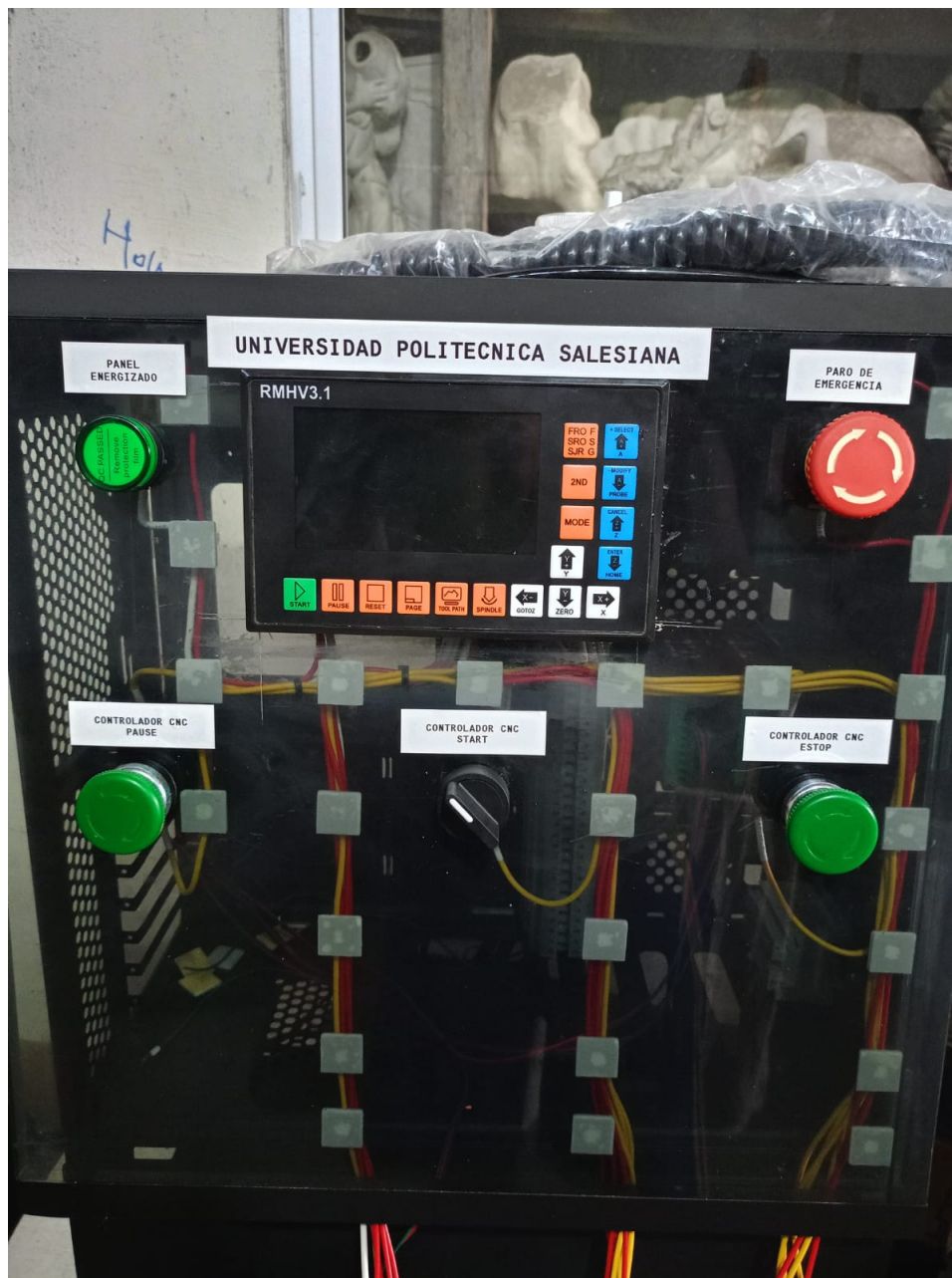
Figura 37. Pulsadores en el Tablero de control, fuente los Autores
