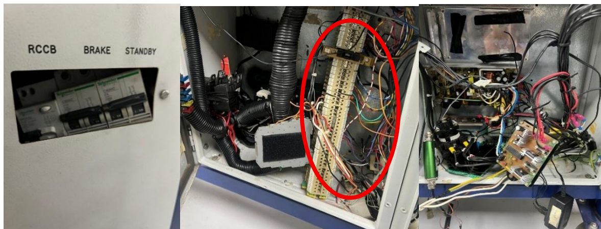
Fig. 14. Gabinete desorganizado y conexiones sueltas.
