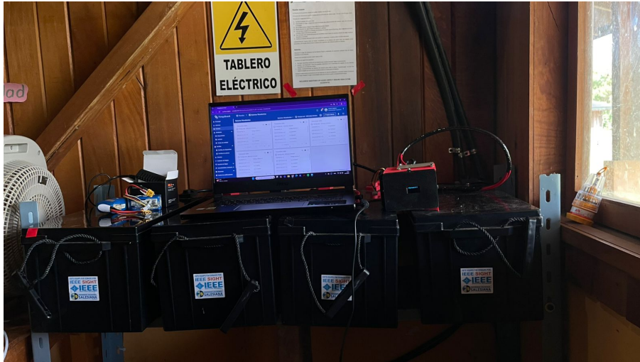
Figura 2.12: Sistema Real Implementado en el Centro de Salud de Wasakentsa
