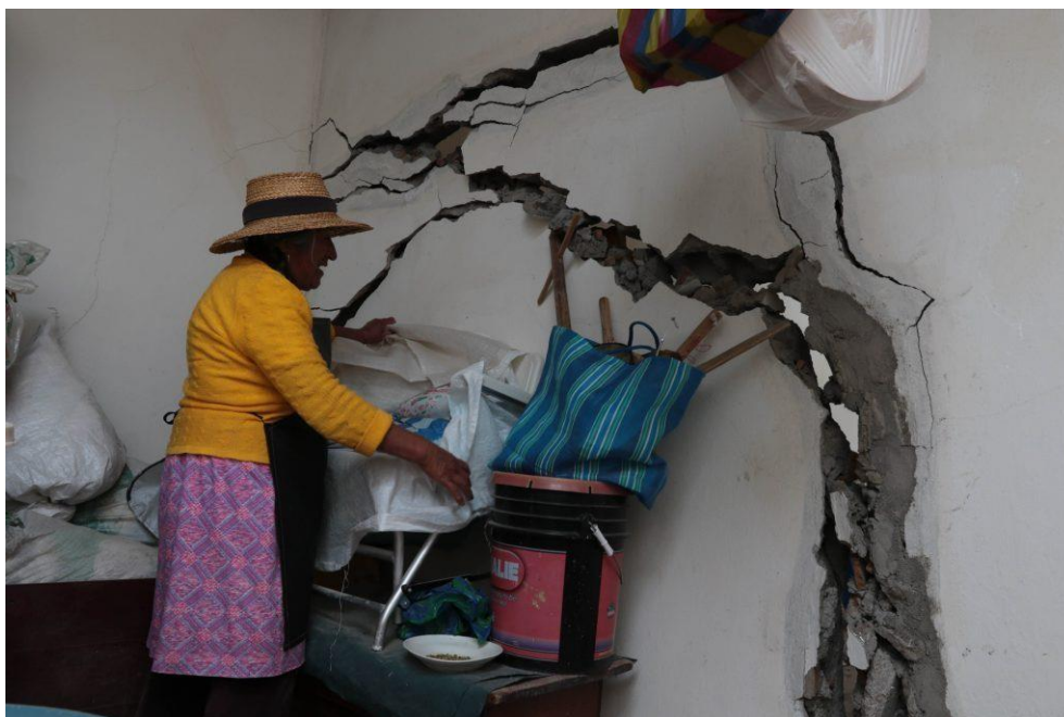
Fotografía 1 Inmueble deteriorado producto del deslizamiento Fuente: (Bustamante Javier, Aguilar Freddy, 2025)
