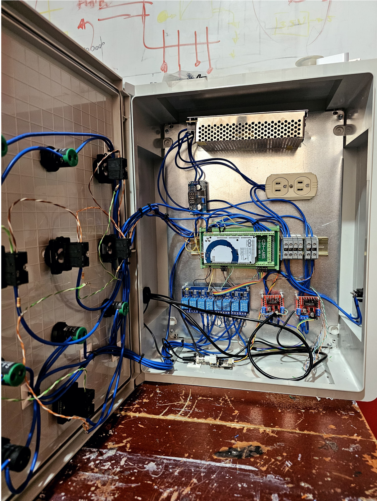
Figura 40. Conexión eléctrica del tablero. Fuente: Los Autores
