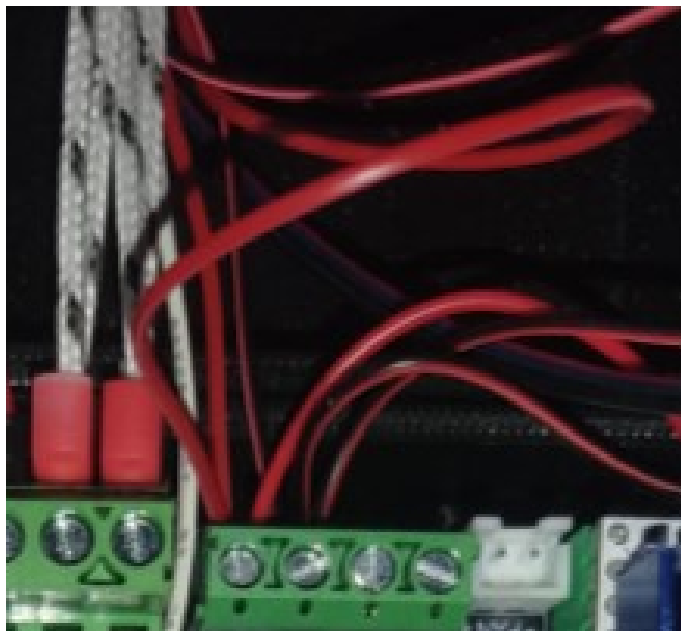
Figura 47. Conexión de los cartuchos calefactores. Fuente propia.
