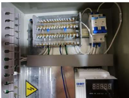
Figura 119. Panel eléctrico : Los autores.
