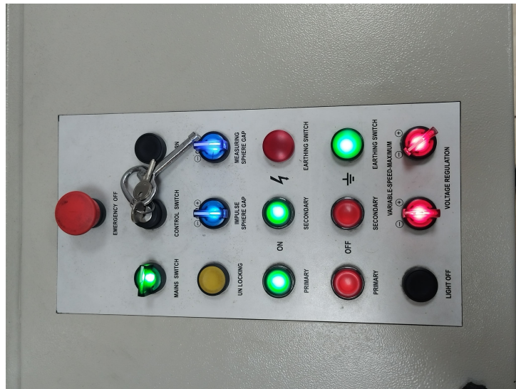
Figura 4: Área de operación del panel de control
