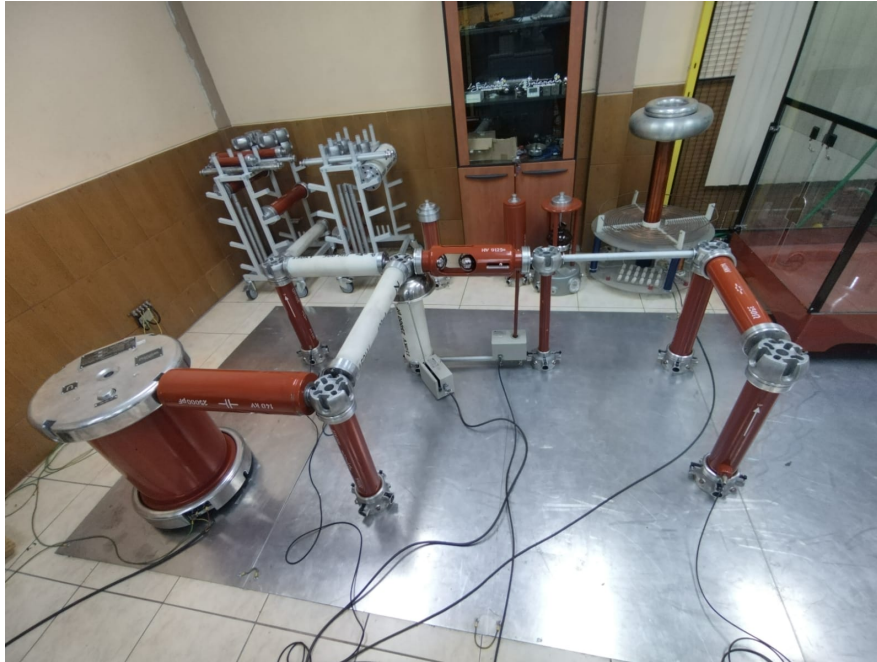
Figura 43: Doblador de tensión con un único capacitor de 150 kV
