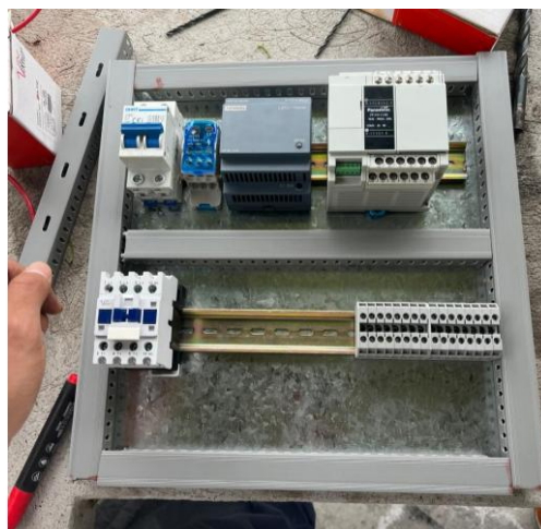
Figura 42. Caja de control con PLC, fuente de alimentación y borneras
