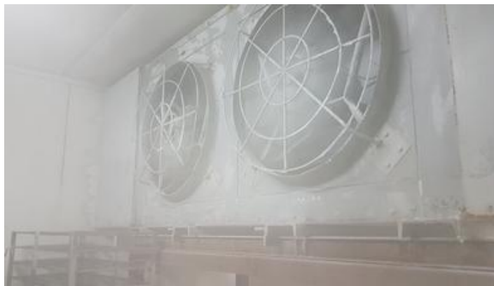
Anexo 13. Evaporador (Túnel 1)
