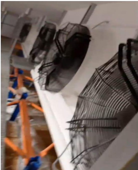
Figura 5. Equipos evaporadores en túnel de congelación
