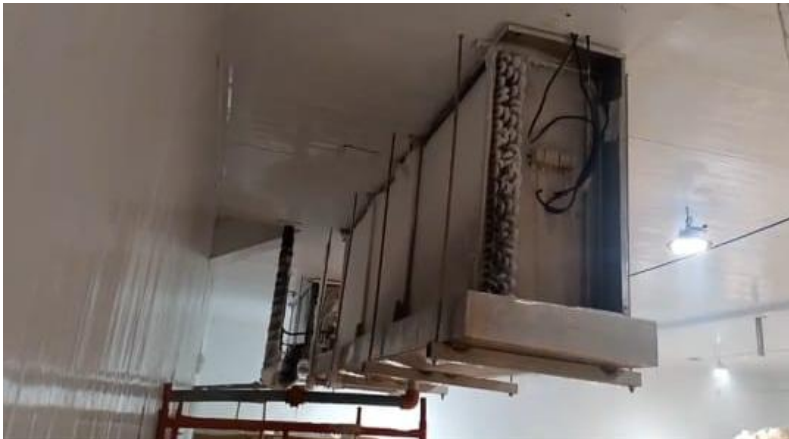
Figura 10. Equipos de frio (Cámara de almacenamiento)
