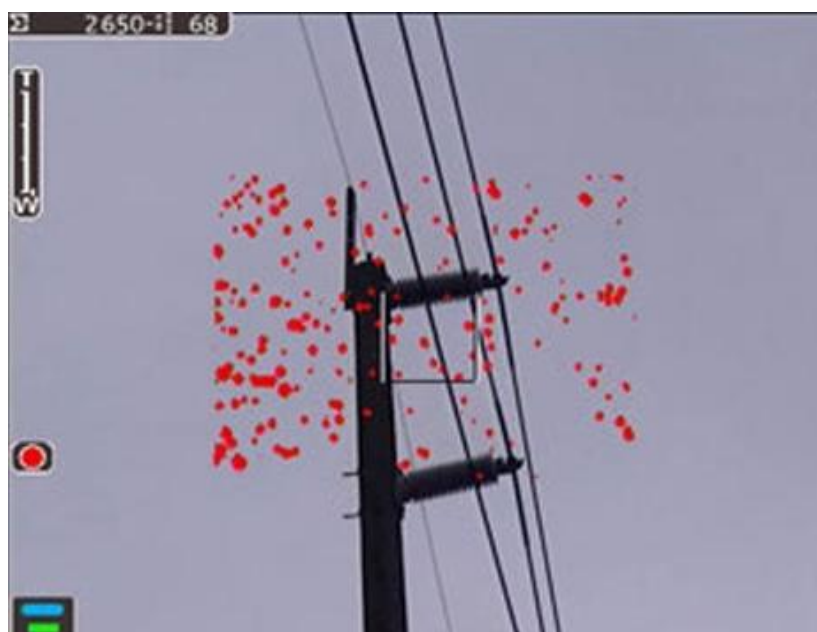
Figura 28. Efecto corona aislador 69 kV Fuente: Anexo 2
