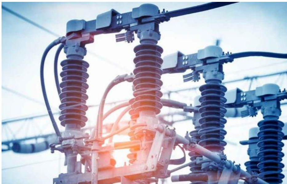
Figura 4. Subestación eléctrica Fuente: Tomado de [19]
