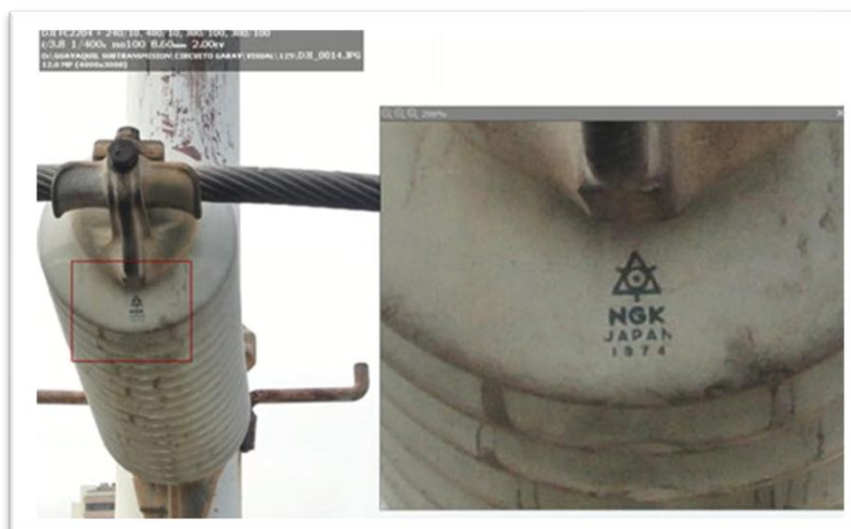
Figura 27. Aislador Flameado en línea de subtransmisión Fuente: Anexo 2
