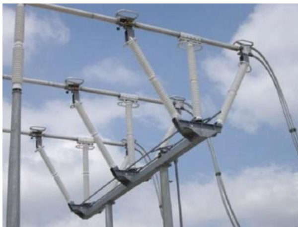
Figura 6. Interruptor seccionador tipo pantógrafo Fuente: Tomado de [24]
