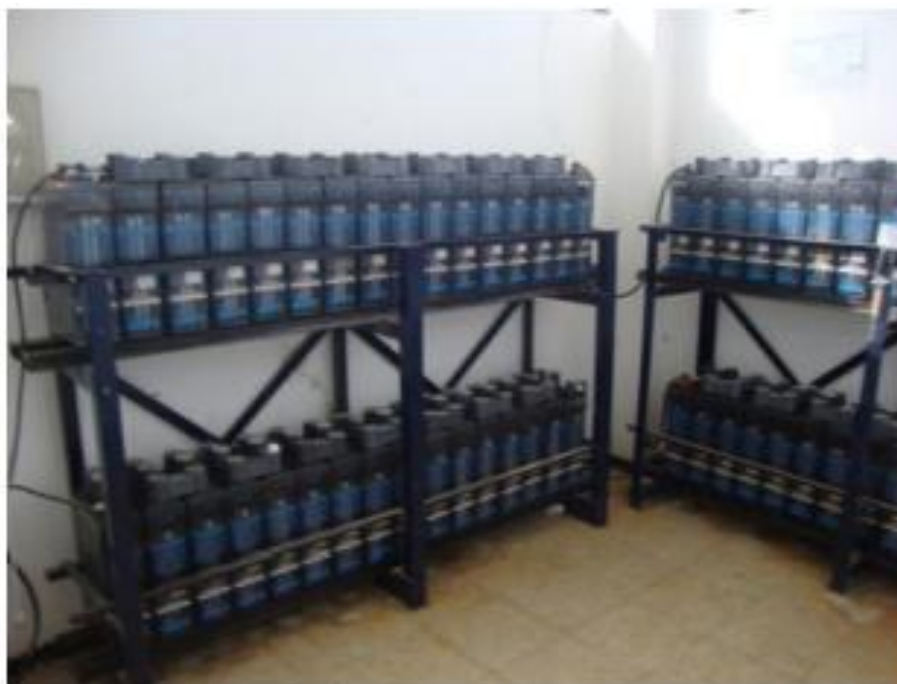
Figura 14. Banco de baterías Fuente: Tomado de [34]
