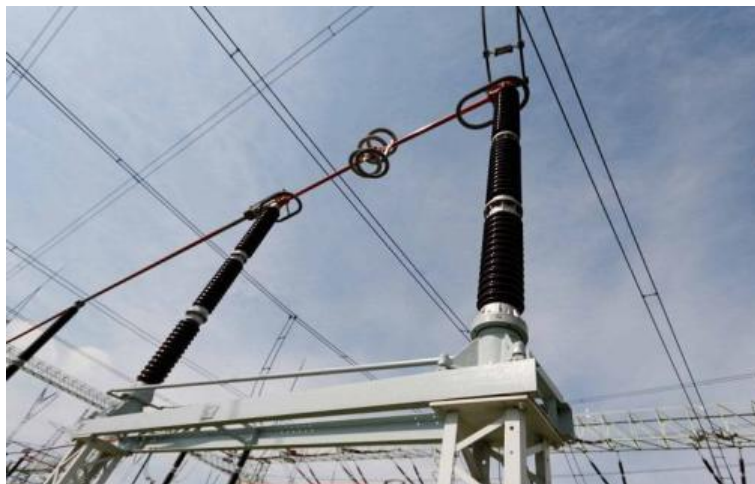
Figura 5. Seccionadores de aire de alta tensión Fuente: Tomado de [24]
