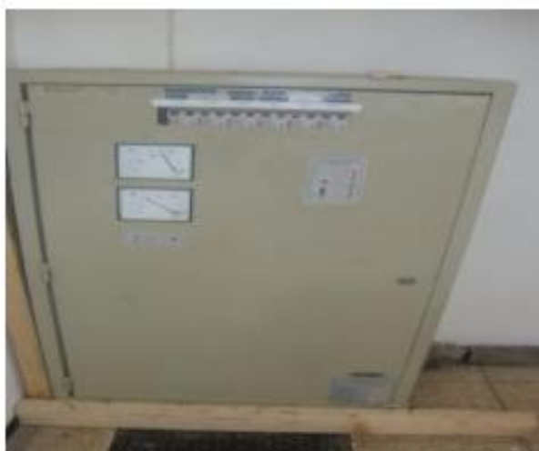
Figura 13. Tablero del cargador de baterías Fuente: Tomado de [34]
