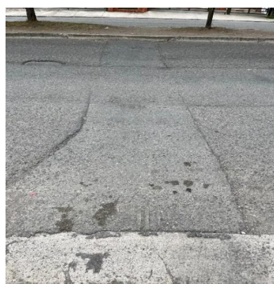
b) Imagen de inspección convencional
