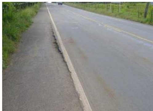
Figura 22. Corrimiento vertical de la berma
