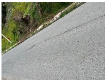
Figura 5. Fisura longitudinal en junta de construcción
