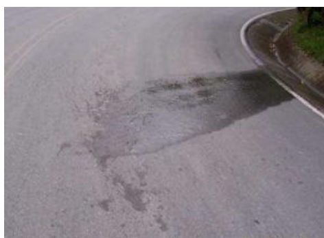
Figura 25. Afloramiento de agua
