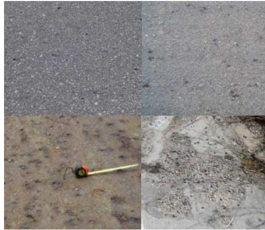
Figura 18. Pérdida de agregado
