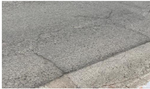
Figura 7. Fisura en medialuna
