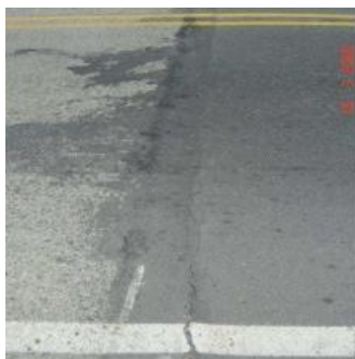
Figura 6. Fisura transversal en junta de construcción.
