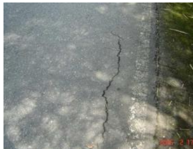
Figura 8. Fisuras de borde
