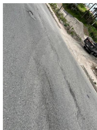
b) Imagen de inspección convencional
