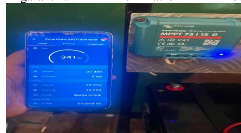
Fig. 3 Controlador Victron SmartSolar MPPT 75/15 instalado en La Masa 2.
