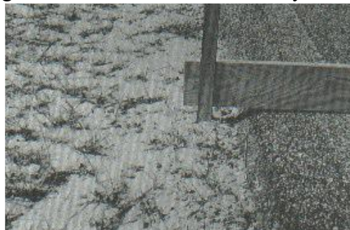
Figura 21: Falla de desnivel carril y berma
