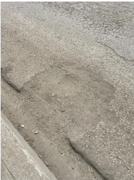
Figura 62. Bache en el borde del pavimento en el tramo 1 (Abscisa: 0+000 / 0+040)
