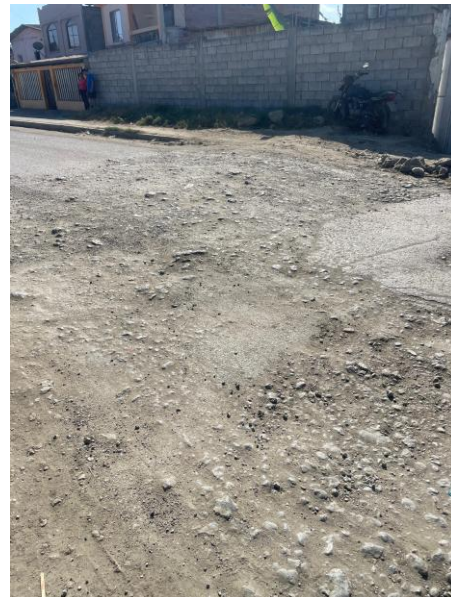
Figura 71. Desprendimiento de agregados en la unidad de muestreo 9 (Abscisa: 0+960 / 1+000)
