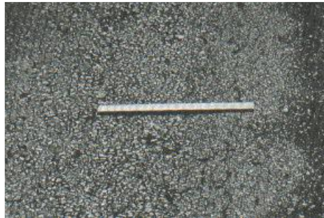
Figura 20: Falla de meteorización
