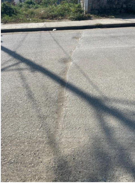
Figura 72. Grieta longitudinal en la unidad de muestreo 10 (Abscisa: 1+080 / 1+120)
