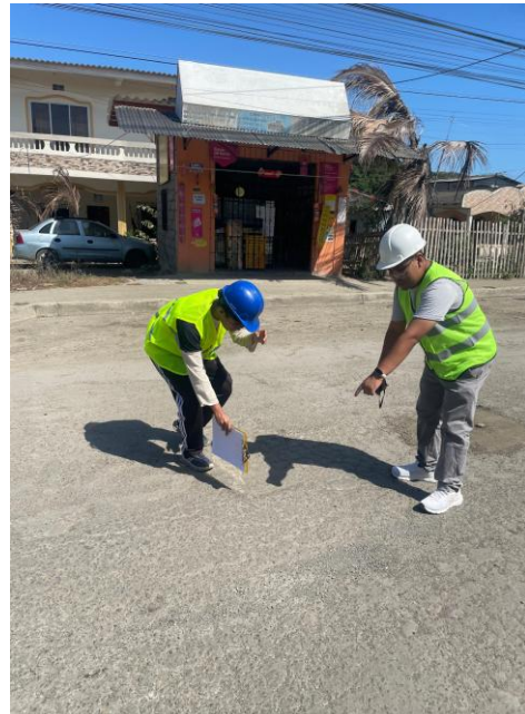
Figura 75. Identificación de fallas en el pavimento
