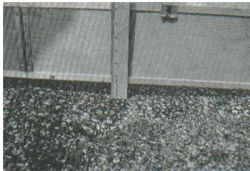
Figura 16: Falla tipo ahuellamiento
