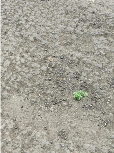
Figura 64. Desprendimiento de agregados en la unidad de muestreo 2 (Abscisa: 0+120/0+160)
