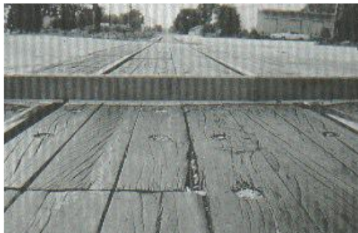
Figura 15: Falla de Cruce de vía férrea
