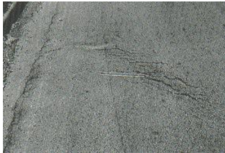
Figura 18: Falla de grietas parabólicas
