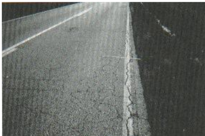
figura 3: Falla piel de cocodrilo
