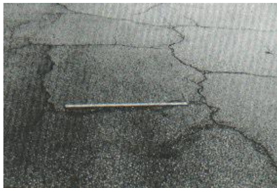
figura 5: Falla grietas en bloque
