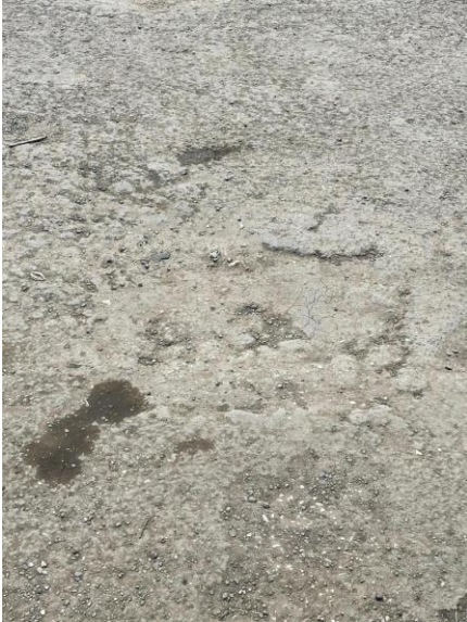
Figura 60. Depresión en el pavimento en el tramo 1 (Abscisa: 0+000 / 0+040)
