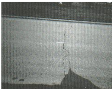
Figura 11: Falla grietas long. Y transversales
