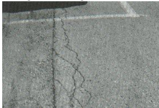
figura 9: Falla grietas de borde
