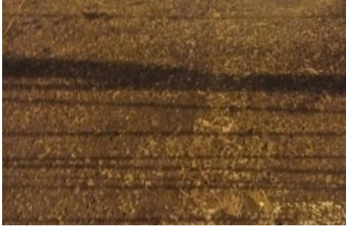
Ilustración 29 Desconchamiento severidad (M)
