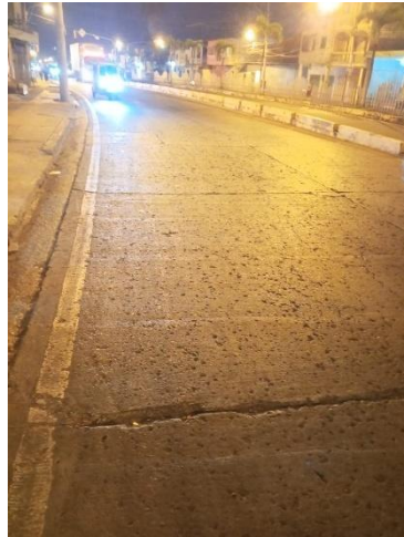
Ilustración 31 falla descascaramiento de junta en la vía
