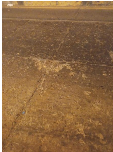
Ilustración 55 descascaramiento de esquina (0.35)
