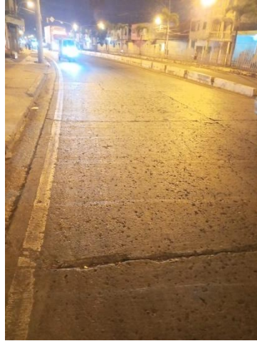
Ilustración 51 descascaramiento de junta (4.16)
