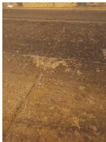
Ilustración 30 falla descascaramiento de esquina en la vía
