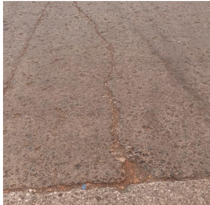
Ilustración 47 grieta de esquina (12.23)
