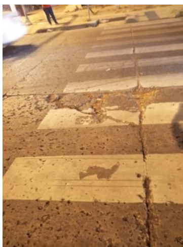
Ilustración 27 Falla punzonamiento en la vía
