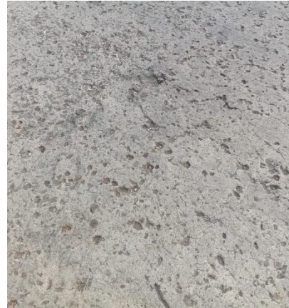
Ilustración 28 Desconchamiento severidad (H)
