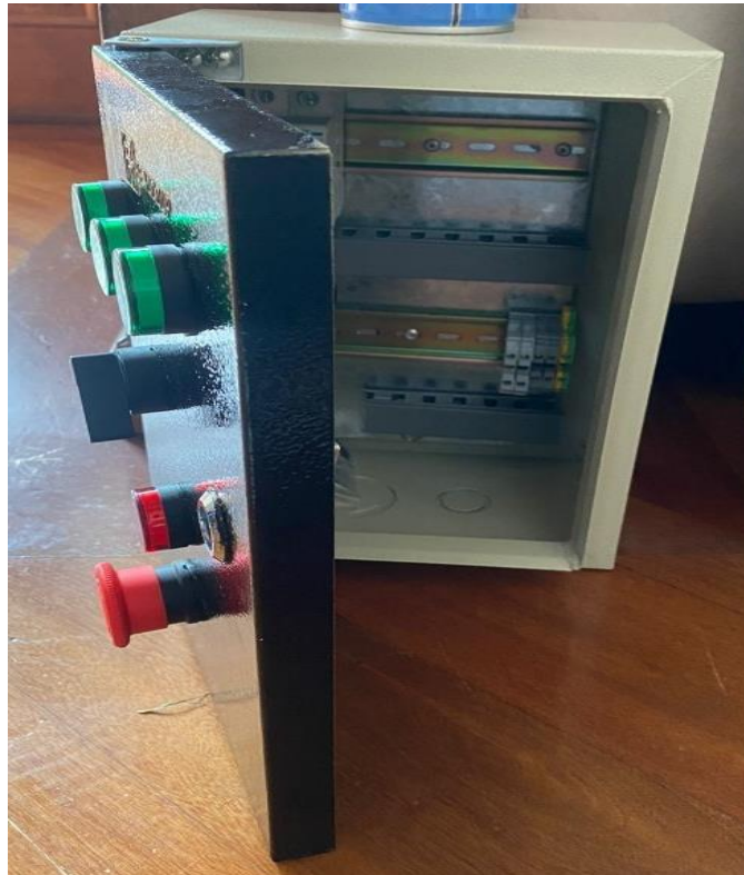
Figura 41. Tablero sin elementos eléctricos internos.
