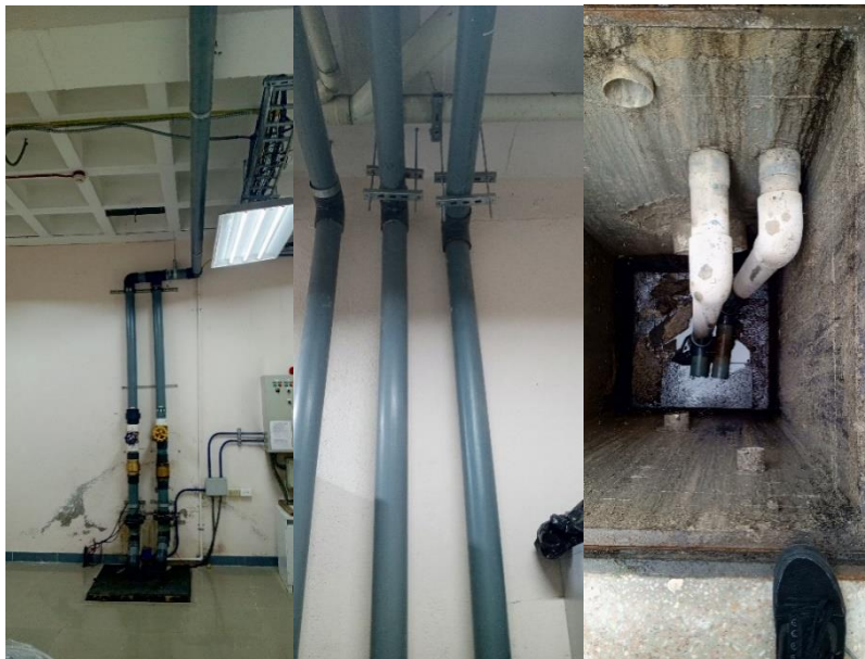
Sistema de Drenaje y Bombeo
