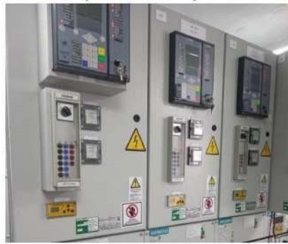
Figura 10 Celda Siemens 8DJH (Fuente: Autor)
