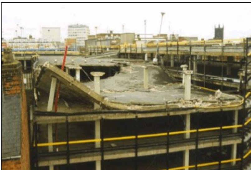
Figura 18 Losas planas con vigas banda. Fallos por punzonamiento
