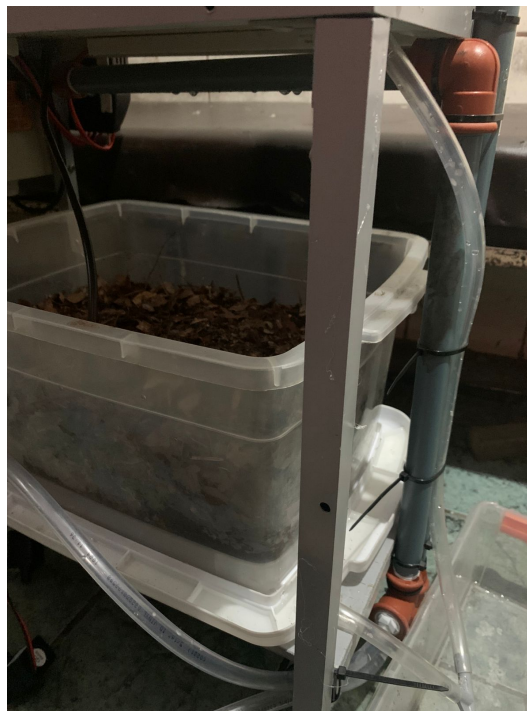
Figura 12. Conexión de la bomba de agua al sistema. Fuente: Los Autores.
