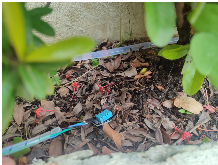
Figura 34. Prueba en condiciones reales . Fuente: Autores
