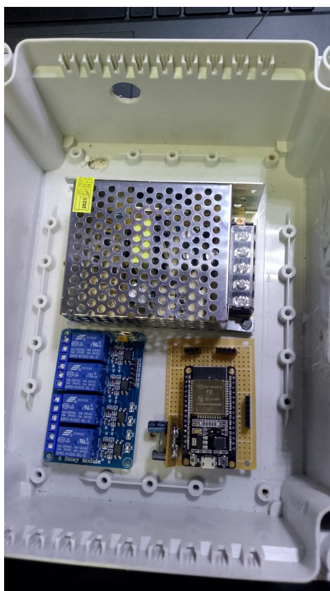
Figura 22. Ensamblaje de la caja de control del sistema de riego. Fuente: Autores
