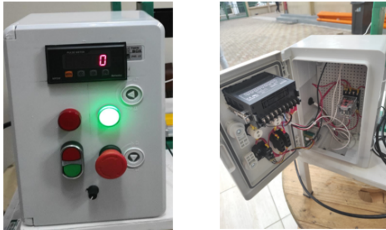
Figura 55. Parte Frontal y Interna del Tablero
