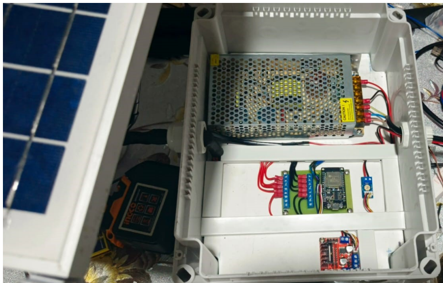
Figura 61: Cableado optimizado y correctamente acomodado en el interior de la caja. Fuente: Autores.
