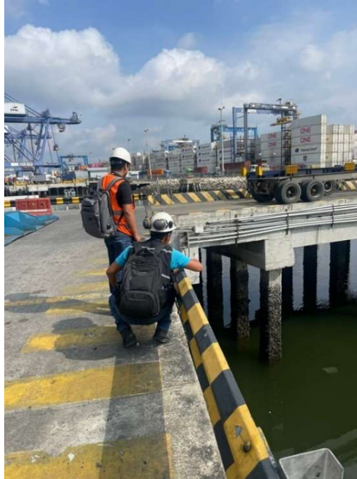
Imagen 15: Estado actual del hormigón bajo muelle portuario
