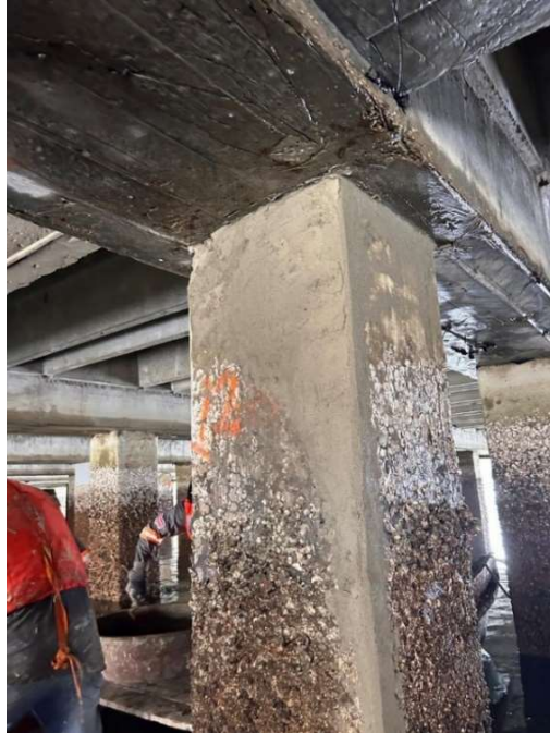
Imagen 5: Estado actual del hormigón bajo muelle portuario
