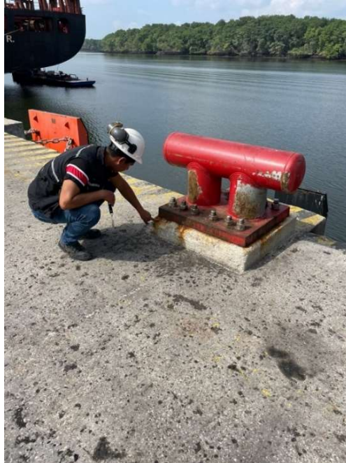
Imagen 17: Estado actual del hormigón bajo muelle portuario
