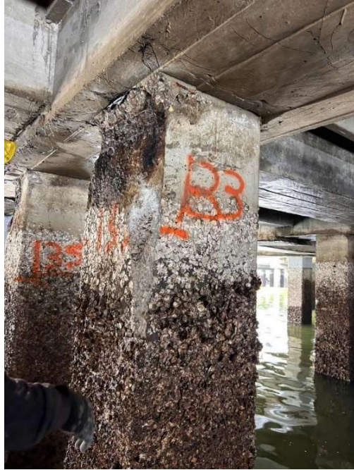
Imagen 7: Estado actual del hormigón bajo muelle portuario
