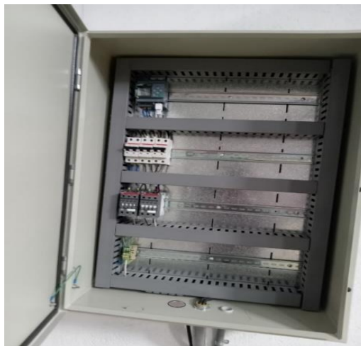
Figura 24 Visualización donde se instalará el nuevo sistema
