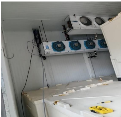
Figura 17 Visualización de desorganización del cableado por falta de Ductos
