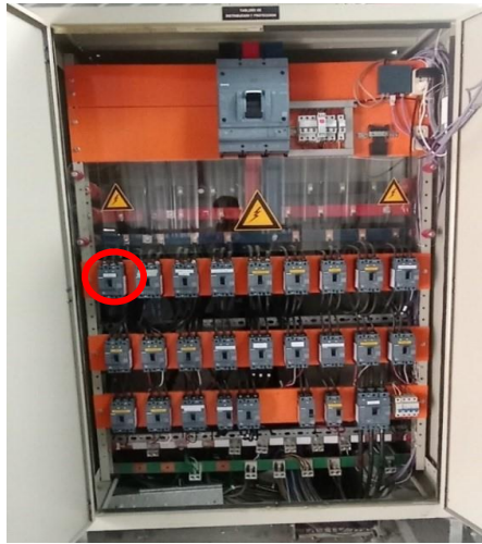
Figura 26 Visualización del el Tablero de Distribución y Protección
