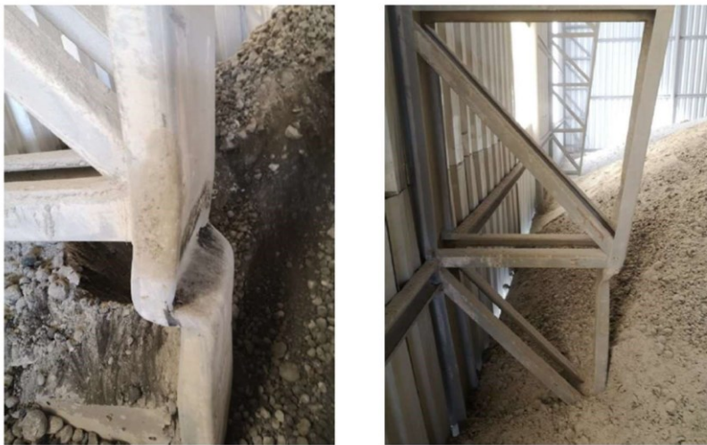
Figura 22. Columnas aparentemente pandeadas con daño estructural en los elementos a compresión de las columnas tipo
