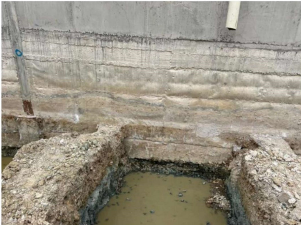
Figura 24 Ausencia de cimientos en los muros
