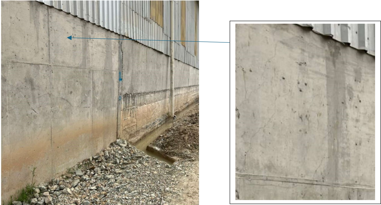
Figura 21 Grietas diagonales en el vano del muro posterior
