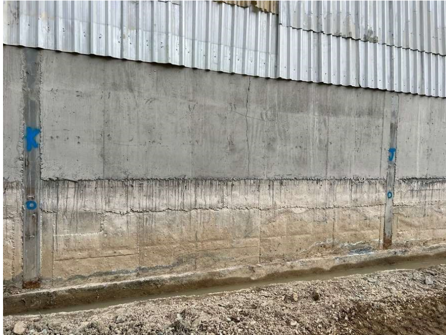
Grietas observadas en visita de campo
