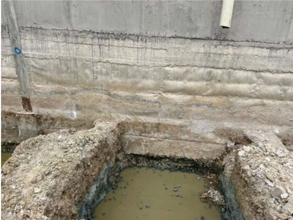
Figura 9 Ausencia de zapata en muro tipo mixto
