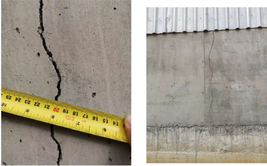
Figura 19 Grietas en el centro de luz de cada pantalla del muro de contención
