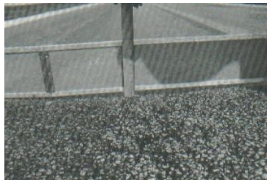
FIGURA 2.20B. AHUELLAMIENTO DE SEVERIDAD MEDIA
