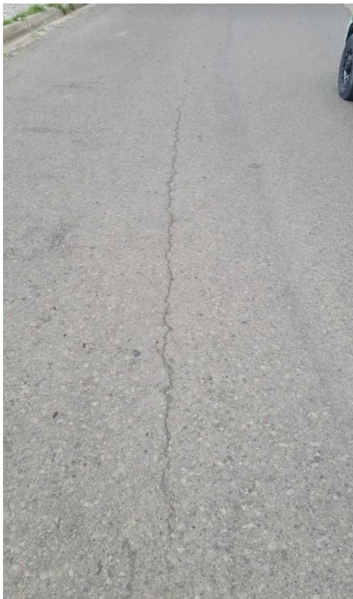
FIGURA 2.15A. GRIETAS LONGITUDINALES Y TRANSVERSALES DE BAJA SEVERIDAD
