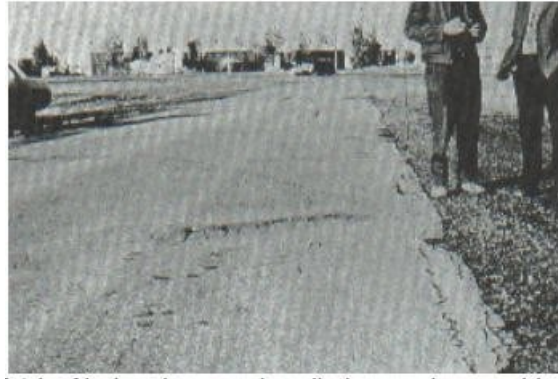
FIGURA 2.9B. ABULTAMIENTO Y HUNDIMIENTOS DE SEVERIDAD MEDIA
