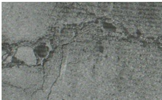
FIGURA 2.15C. GRIETAS LONGITUDINALES Y TRANSVERSALES DE ALTA SEVERIDAD
