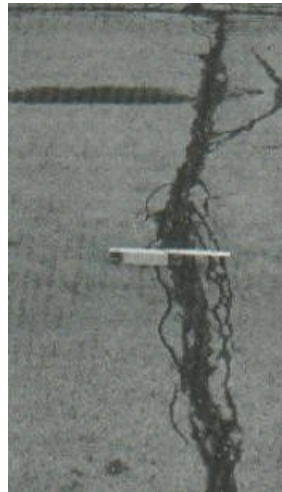
FIGURA 2.13C. GRIETA DE REFLEXIÓN DE JUNTA DE ALTA SEVERIDAD
