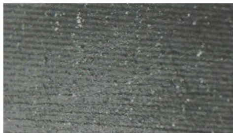
FIGURA 2.7C. EXUDACIÓN DE SEVERIDAD ALTA
