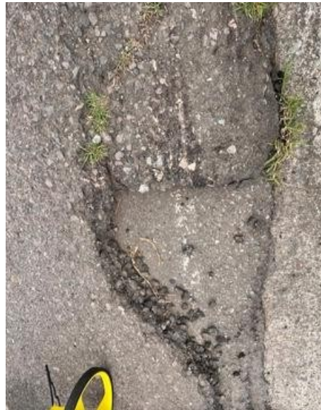
FIGURA 2.18A. HUECO DE BAJA SEVERIDAD
