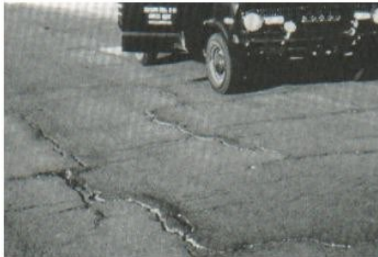
FIGURA 2.8C. AGRIETAMIENTO EN BLOQUE DE ALTA SEVERIDAD
