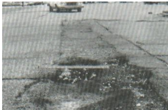
FIGURA 2.16C. PARCHEO Y ACOMETIDAS DE SERVICIOS PÚBLICOS DE ALTA SEVERIDAD
