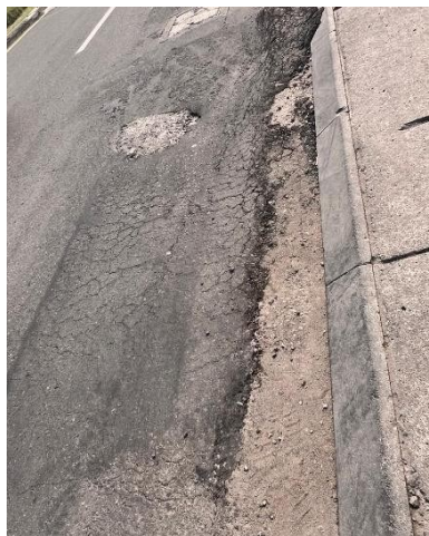
FIGURA 2.6C. PIEL DE COCODRILO DE ALTA SEVERIDAD
