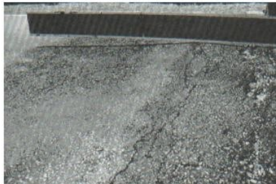
FIGURA 2.9C. ABULTAMIENTO Y HUNDIMIENTOS DE ALTA SEVERIDAD
