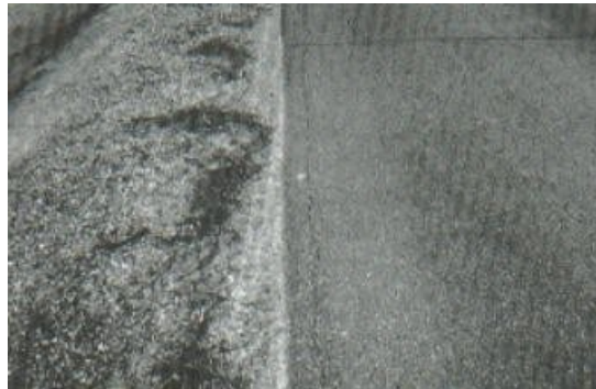
FIGURA 2.12A. GRIETA DE BORDE DE BAJA SEVERIDAD
