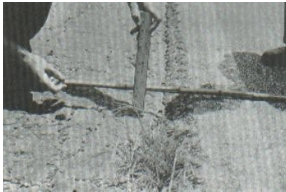
FIGURA 2.14B. DESNIVEL CARRIL/BERMA DE SEVERIDAD MEDIA
