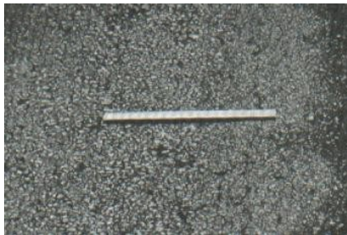
FIGURA 2.24A. DESPRENDIMIENTO DE AGREGADOS DE BAJA SEVERIDAD
