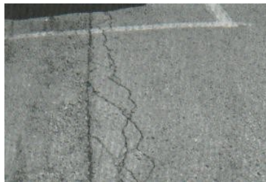
FIGURA 2.12B. GRIETA DE BORDE DE SEVERIDAD MEDIA
