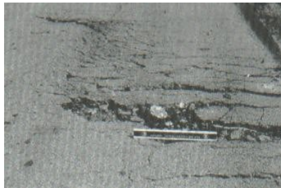
FIGURA 2.22C. GRIETA PARABÓLICA DE ALTA SEVERIDAD
