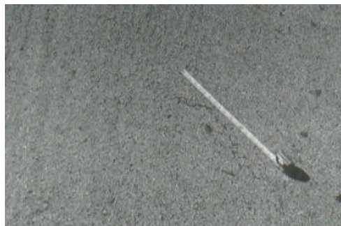
FIGURA 2.22A. GRIETA PARABÓLICA DE BAJA SEVERIDAD
