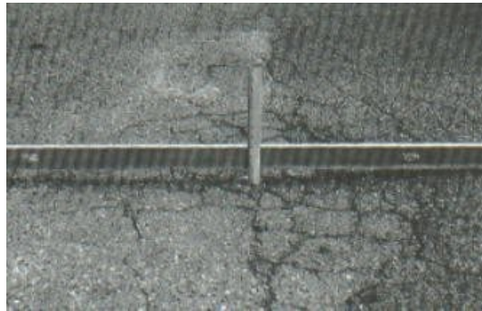
FIGURA 2.11B. DEPRESIÓN DE SEVERIDAD MEDIA
