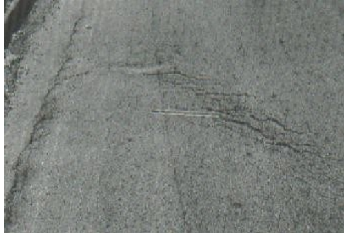
FIGURA 2.22B. GRIETA PARABÓLICA DE SEVERIDAD MEDIA
