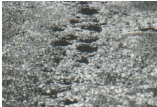
FIGURA 2.24C. DESPRENDIMIENTO DE AGREGADOS DE ALTA SEVERIDAD
