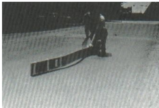
FIGURA 2.21A. DESPLAZAMIENTO DE BAJA SEVERIDAD
