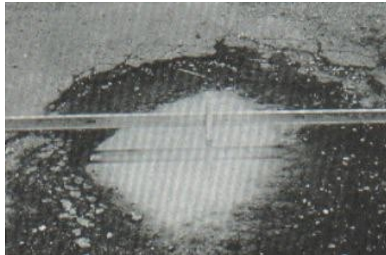
FIGURA 2.18C. HUECO DE ALTA SEVERIDAD
