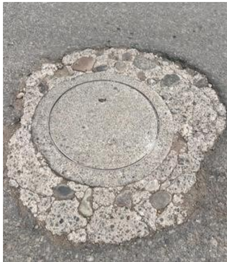
FIGURA 2.16A. PARCHEO Y ACOMETIDAS DE SERVICIOS PÚBLICOS DE BAJA SEVERIDAD
