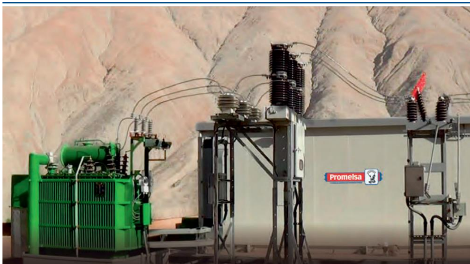
Figura 7. Transformador de potencia
