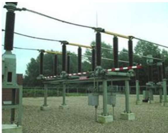
Imagen 11. Seccionador de columnas giratorias Fuente: SectorElectricidad.com
