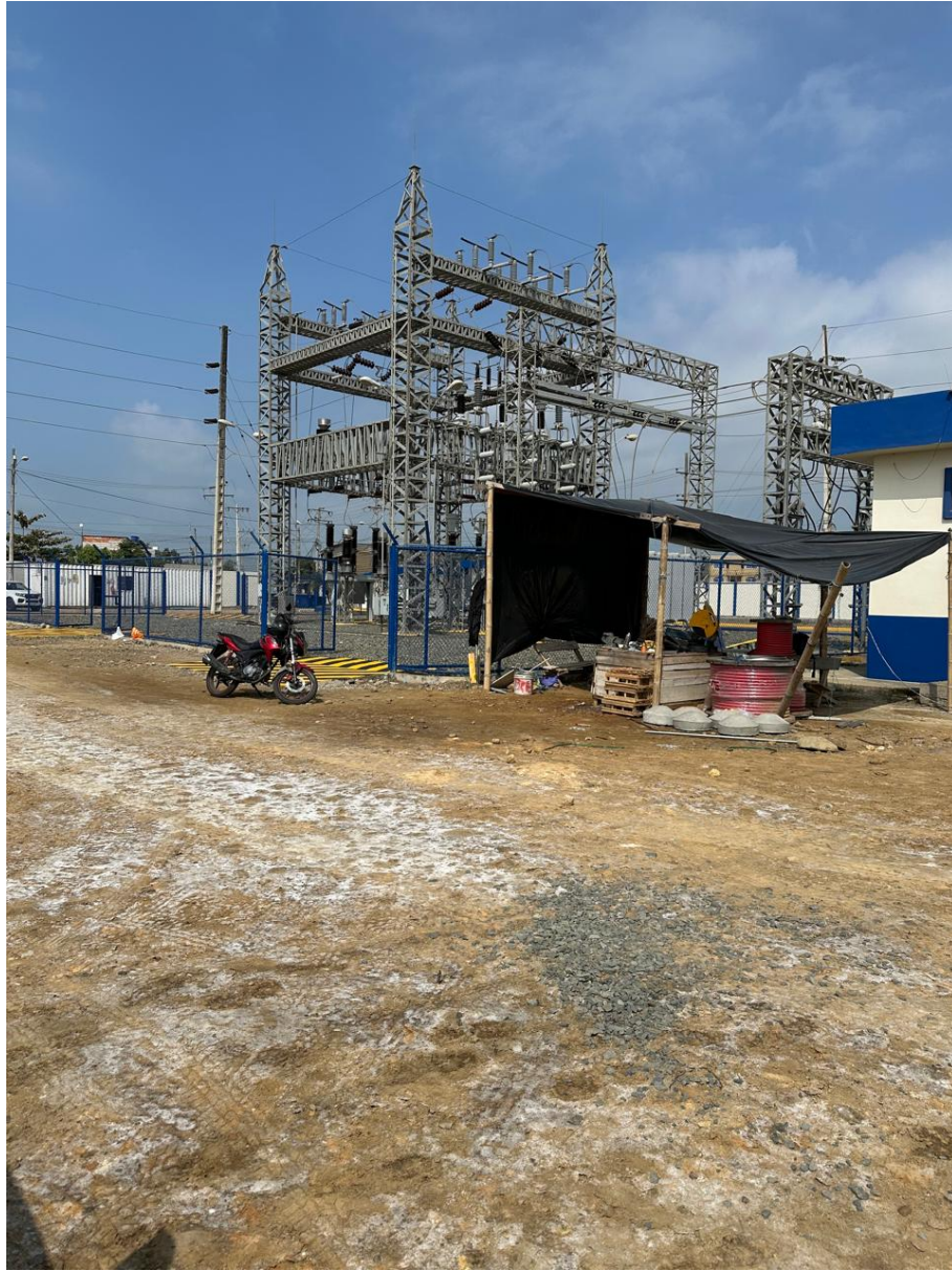
Figura 5.1: Subestación Eléctrica La Primavera
