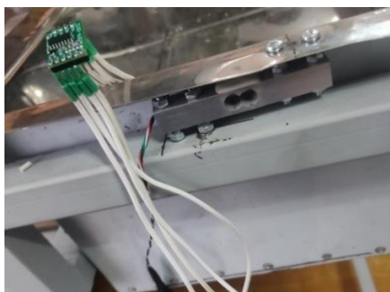
Figura 56. Conexión de sensores de peso.
