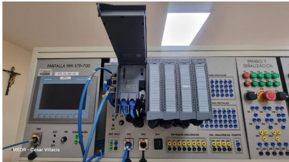
Figura 53: Modulo PLC S7-1500.
