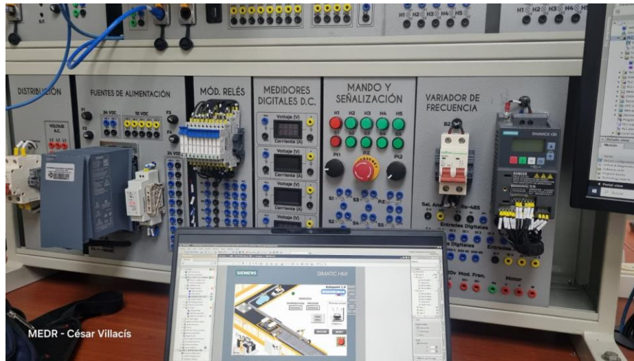
Figura 54: HMI en módulo.
