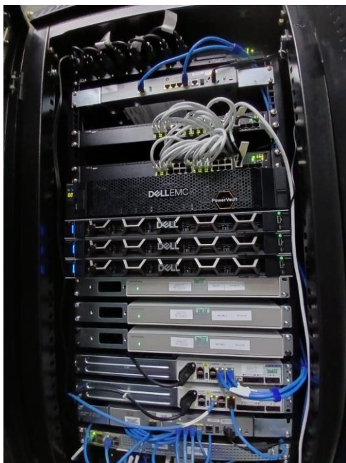
Rack de servidores actuales foto 1
