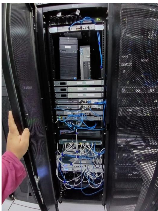
Rack de servidores actuales foto 2
