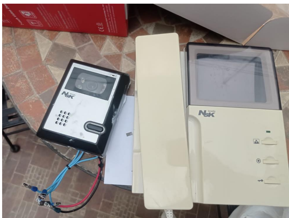
Figura 28. Desmontaje de Portero Vigilante
