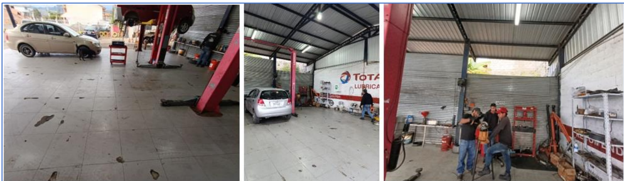
Fotografía 3. Áreas del taller que no cumplen con señales de seguridad industrial.
