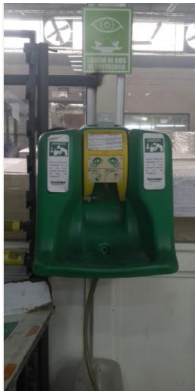
Figura 25. Estación de Lavaojos.
