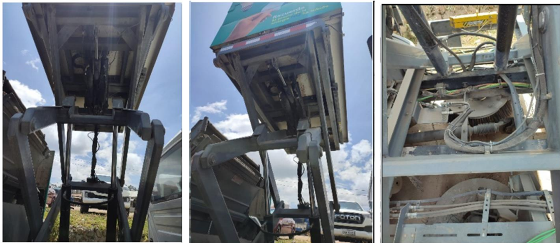
Figura 58. Vista de la tolva y su sistema hidráulico.
