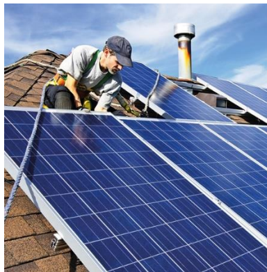
Figura 11. Utilización de Sistema Fotovoltaicos en SEP.
