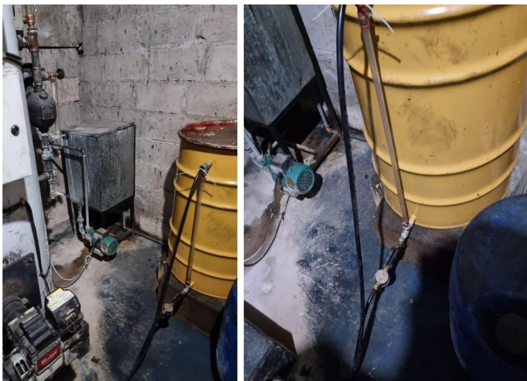
Figura 14. Uso de combustibles fósiles y la conexión hacia el caldero.
