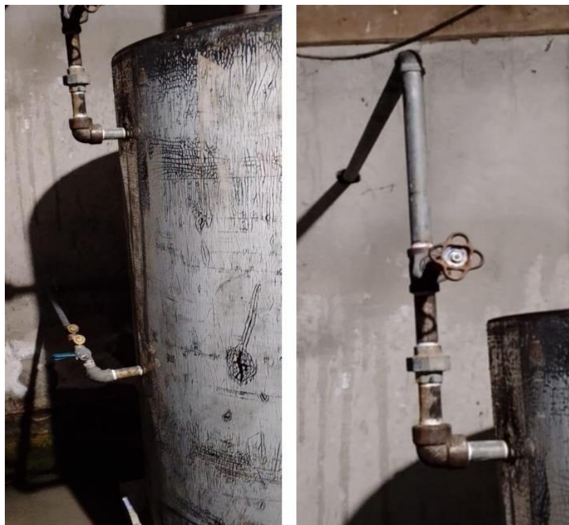
Figura 16. Línea de ingreso de agua y salida de vapor al caldero.
