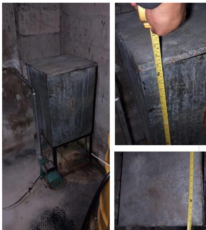
Figura 15. Tanque reservorio de agua.
