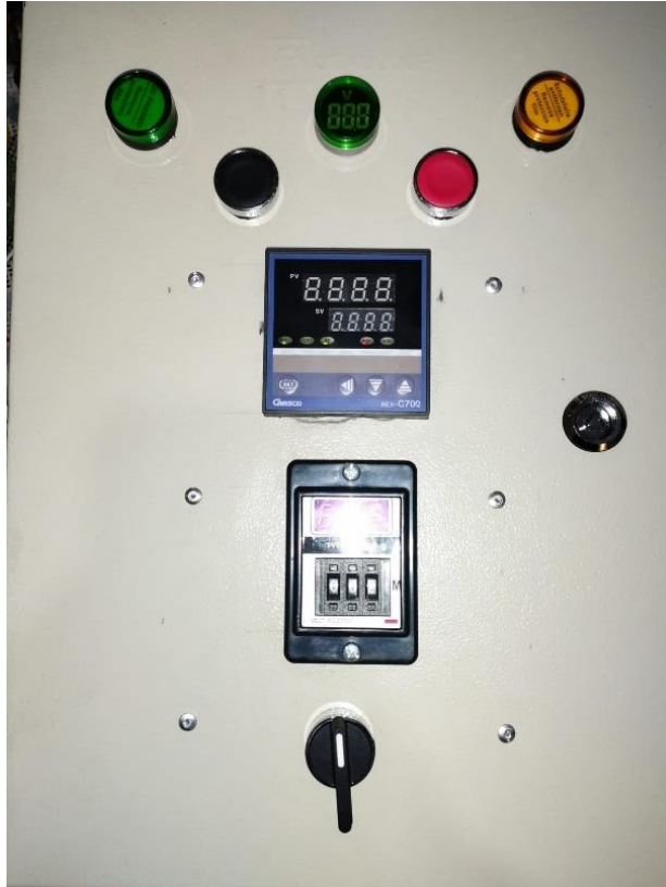
Fig.32. Vista frontal del panel de control.
