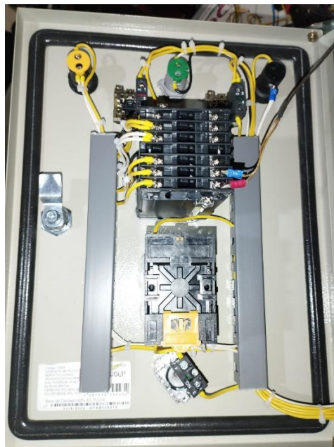
Fig.30. Tablero de control y potencia rediseñado (Parte 1).
