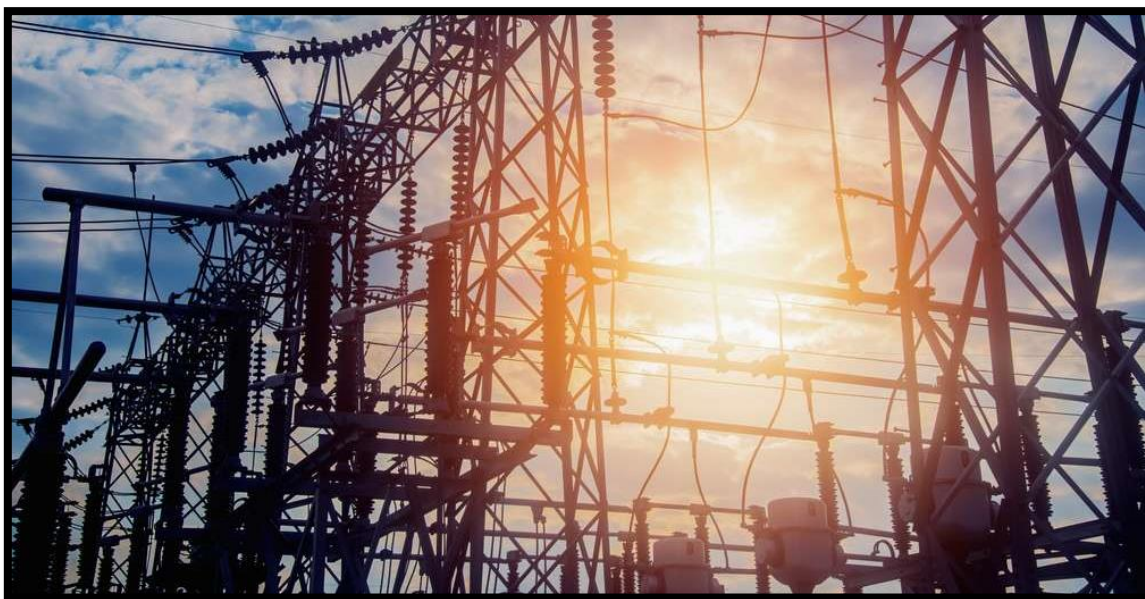
Figura 16. Líneas de transmisión de energía eléctrica.
