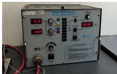
Figura 3. Banco de carga y descarga de baterías níquel-cadmio.
