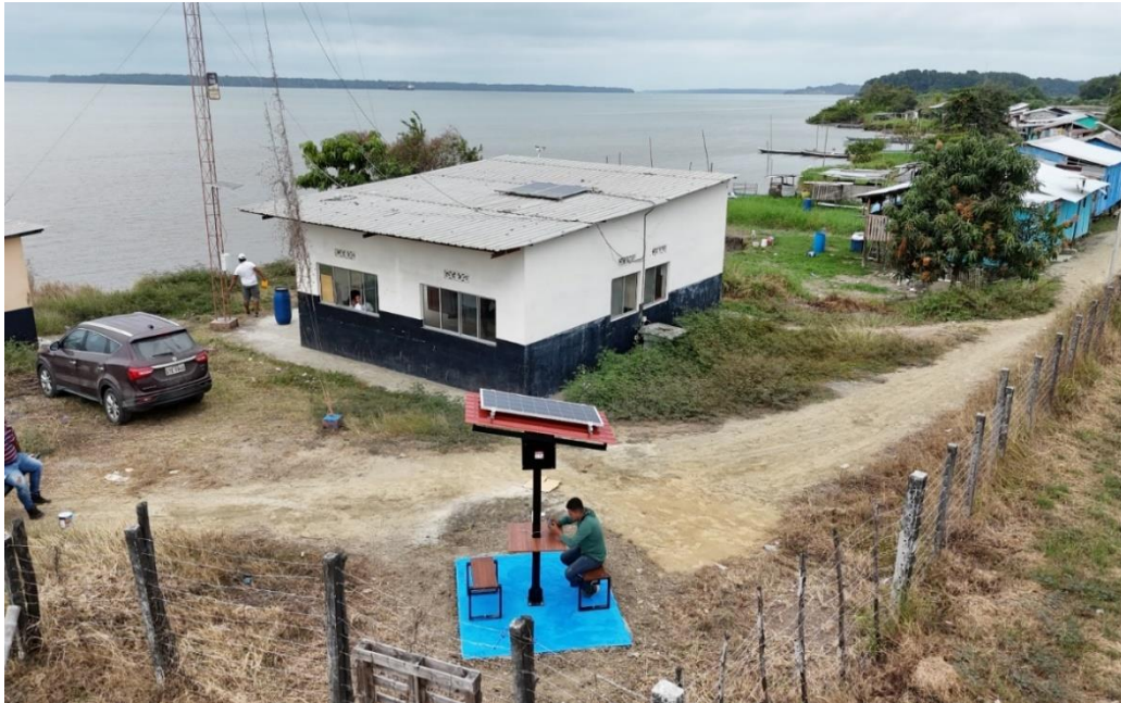
Figura 39. Prueba de la estación
