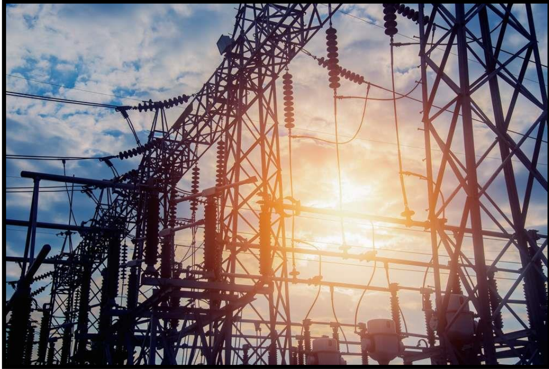
Figura 6. Subestación eléctrica a la cual le llegan líneas del sistema de transmisión de energía eléctrica.
