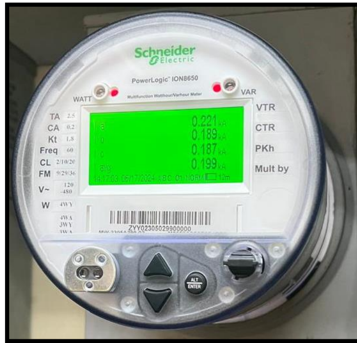
Figura 18. Medidor Schneider Electric.
