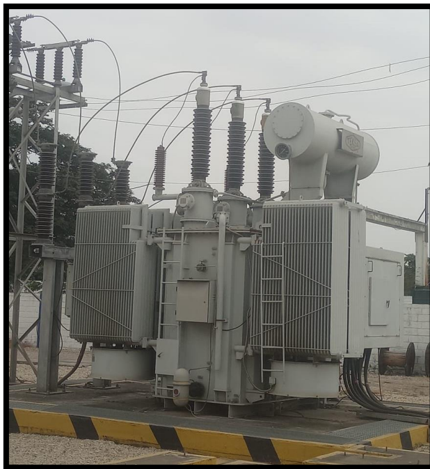
Figura 15. Transformador Número 2 con una capacidad de 18/24 MVA.
