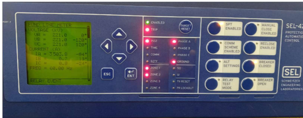
Figura 87. Comportamiento del relé para Falla Monofásica a Tierra al 75% Fuente: Los Autores – Laboratorio de Protecciones
