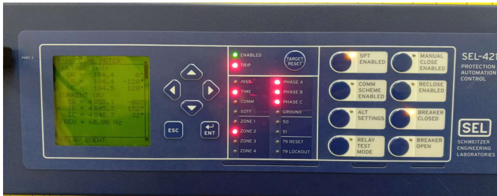
Figura 84. Comportamiento del Relé SEL-421 para la Falla Trifásica al 85% Fuente: Los Autores – Laboratorio de Protecciones
