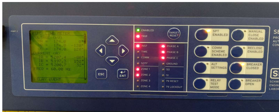
Figura 82. Comportamiento del Relé SEL-421 para la Falla Trifásica al 75% Fuente: Los Autores – Laboratorio de Protecciones
