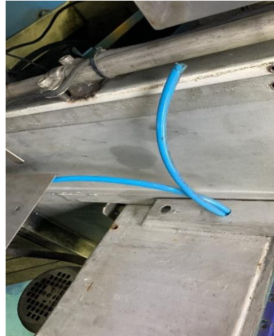
Figura 25. Manguera dañada en termo encogido
