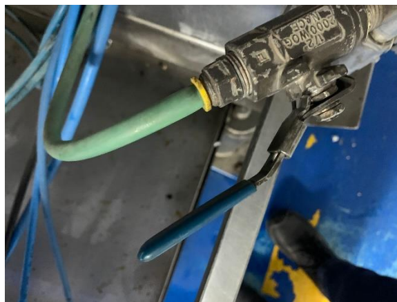
Figura 21. Fuga de Racors de válvula principal de llenadora
