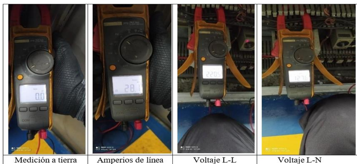
Figura 30. Mediciones de parámetros en panel Termo Galón.
