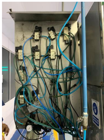
Figura 17. Llenadora parte interna tablero de electroválvula
