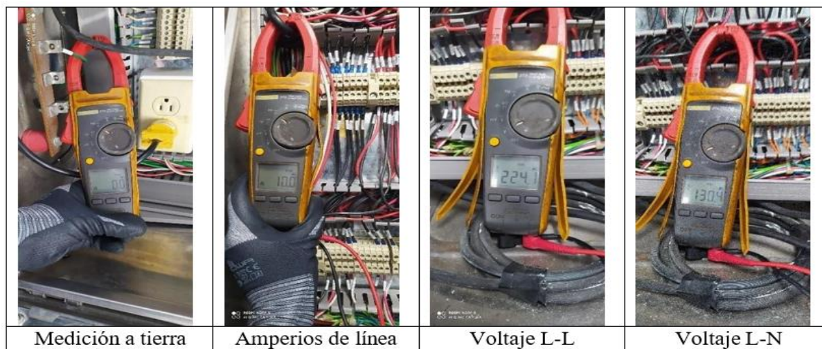
Figura 31. Mediciones de parámetros en panel Lavadora Botellón
