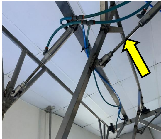
Figura 22. Fuga de aire en unión T de mangueras de alimentación
