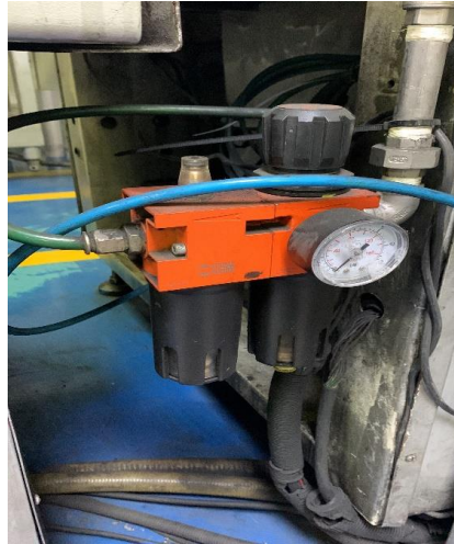
Figura 23. Fuga de aire en unidad de mantenimiento
