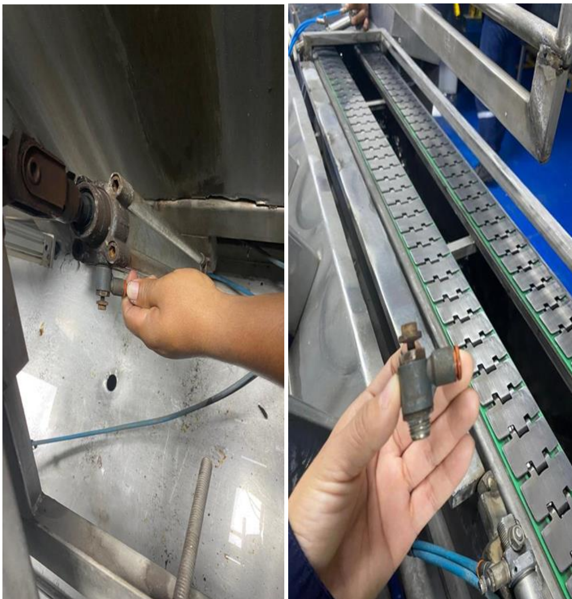
ANEXO5. Acoples de aire comprimidos analizados con fuga
